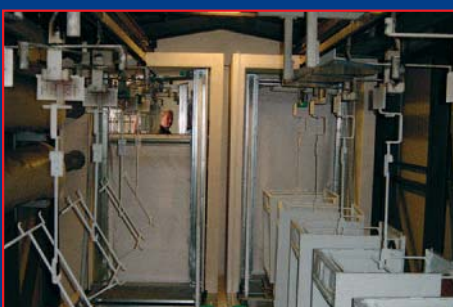
Posuvná přepážková rovina u kruhového dopravníku s textilním protipožárním uzávěrem
