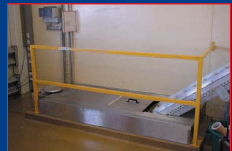
Šachtový pásový dopravník
